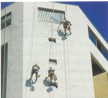
Fissuração mapeada causada por retração de secagem da argamassa
